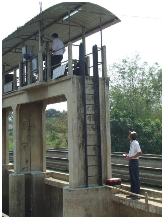
ภาพที่ 1 การตรวจสอบ RTU และอุปกรณ์เชื่อมต่อบริเวณประตุน้ำดันสน
