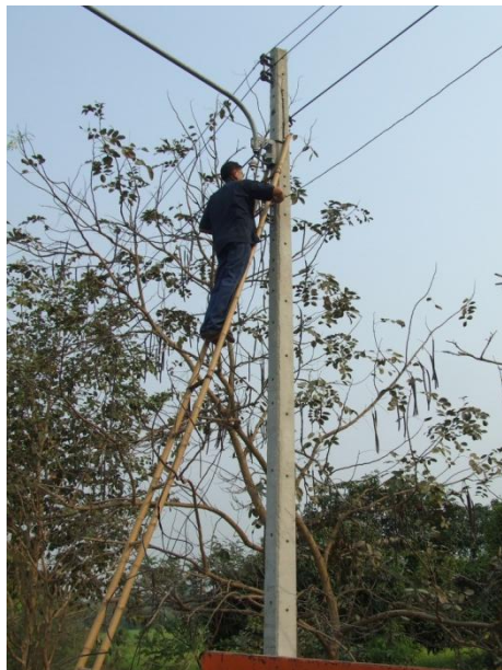
ภาพที่ 4 การตรวจสอบสายสัญญาณซึ่งเดินไปตามแนวเสาไฟ
